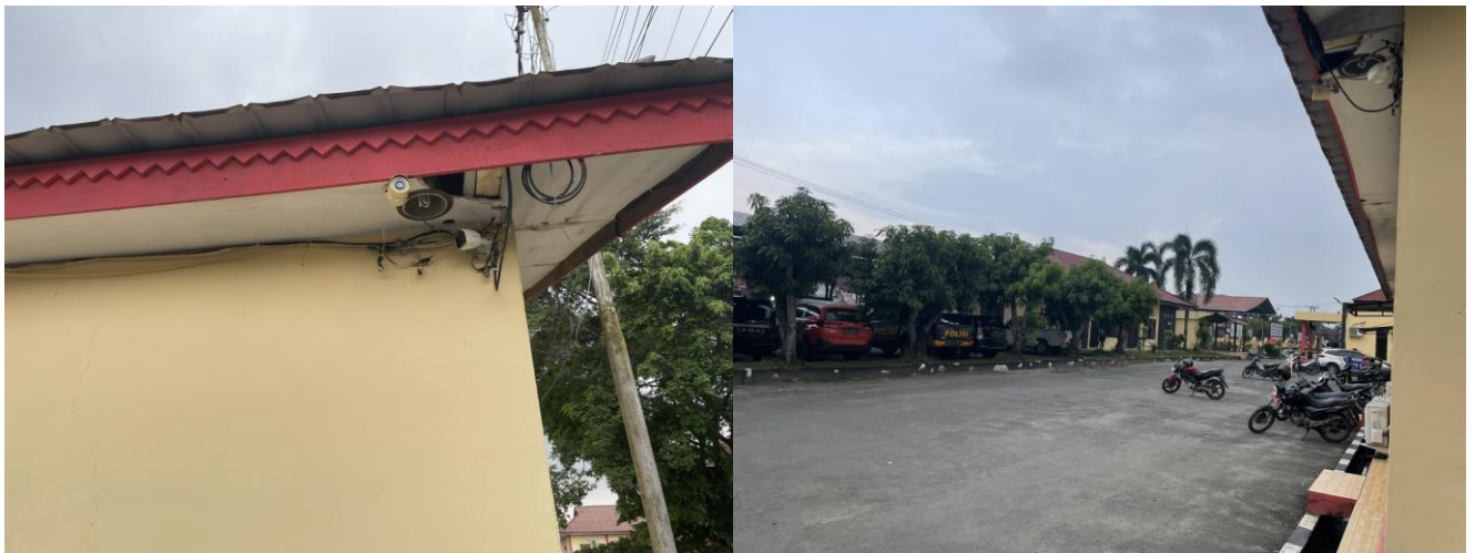
CCTV YANG MENGARAH KE PARKIRAN
